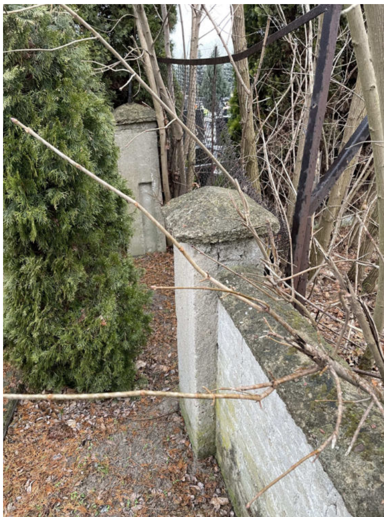
Fot. 18 Widok ścian i słupków ogrodzeniowych – brakujące przesło lub brama ogrodzeniowa – od strony wschodniej
